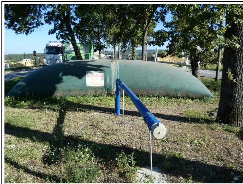
Réserve incendie (120 m 3 ).
